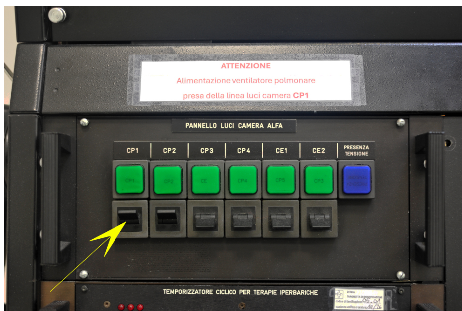
Figure 62. Interruttori luci al quadro di controllo - by Andrea Congiu
