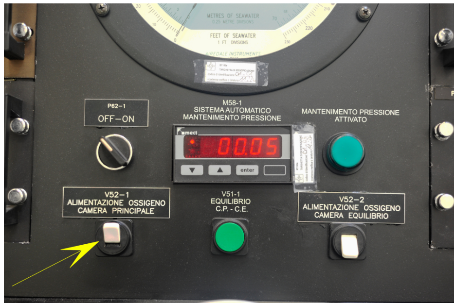
Figure 65. Interruttore ossigeno al quadro di controllo - by Andrea Congiu
